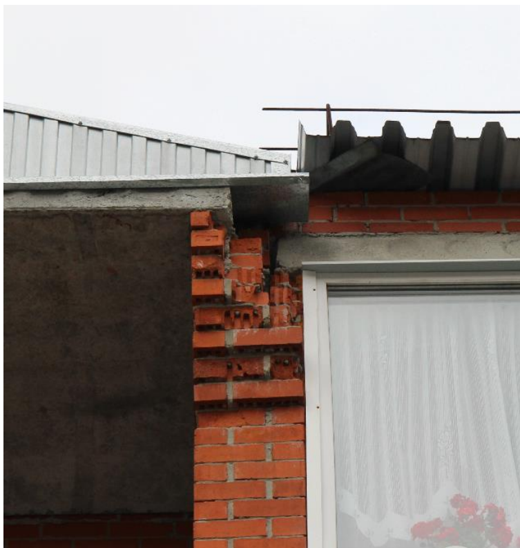
Фото №32. Характерный расклинивающий эффект с расслоением кладки на 8-9 рядов под ж/б плитами козырьков и поджий в уровне 4-го этажа дома по ул. Магистральная 24/3 подъезд №4.
