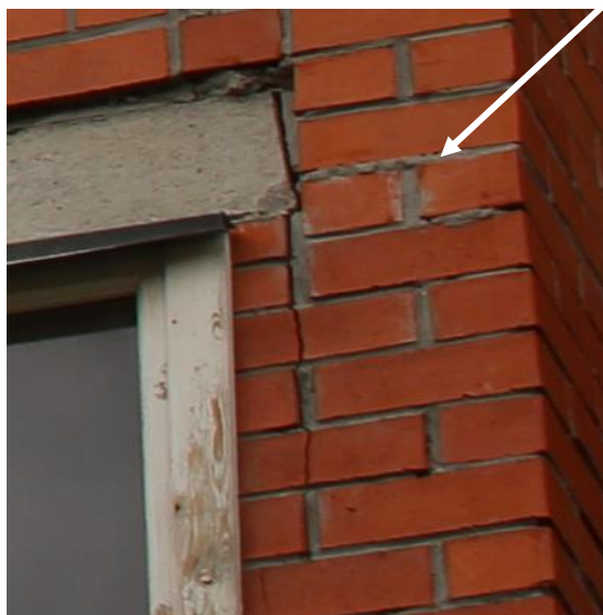
Фото №42. Типовое развитие трещин стенок лоджий.
