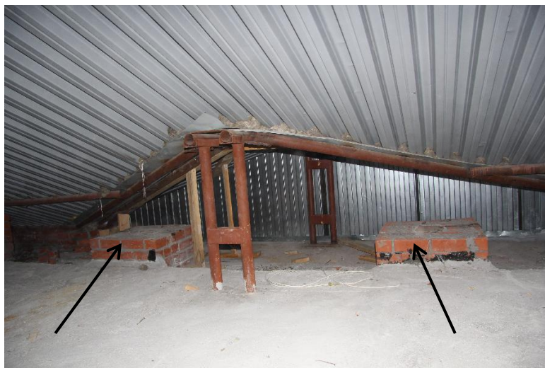
Фото №20. Промежуточные опоры под P-2 по оси В-В отсутствуют при наличии тумб и закладных.
