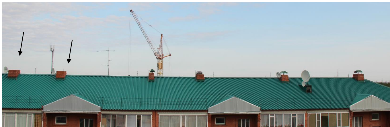
Фото №54. Зонты вентиляционных оголовков сорваны.
