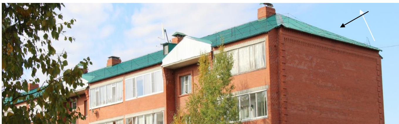
Фото №55. Сорванные снего-ледяными массами ограждения кровли.
