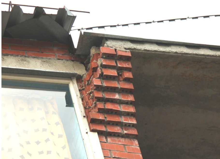
Фото №31. Характерный расклинивающий эффект с расслоением кладки на 8-9 рядов под ж/б плитами козырьков и лоджий в уровне 4-го этажа дома по ул. Магистральная 24/3 подъезд №3.
