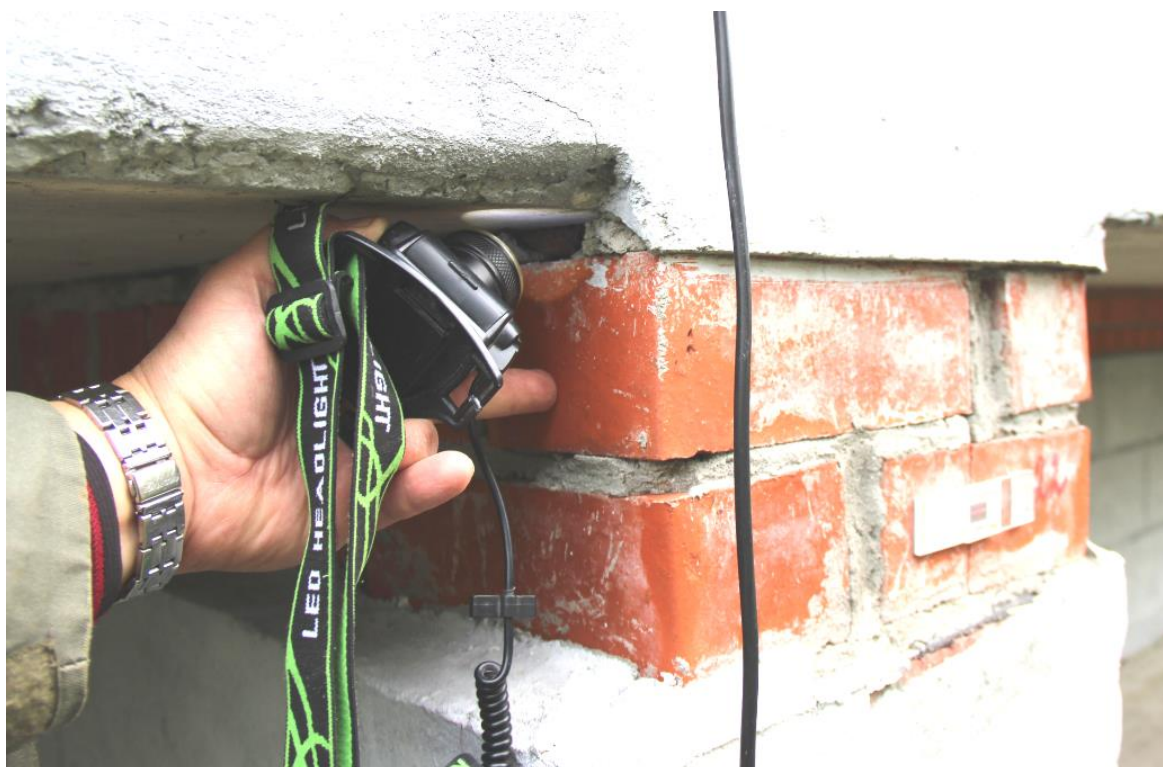
Фото №34. Ул. Магистральная 24/3. Кусок арматуры периодического профиля 16 мм. Ось А-А.
