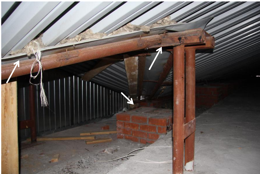
Фото №25. Неправильно установленные при строительстве косынки , отсутствие антикоррозионной обработки, отсутствие промежуточных опор под Р2 ( из результатов обследования в феврале 2022г.)
