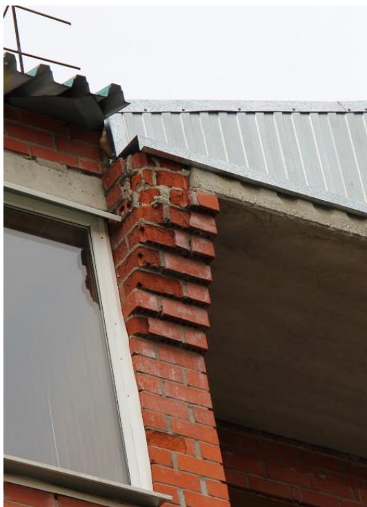
Фото №30,31. Наиболее разрушенные участки кладки карнизов стенок лоджий домов по ул. Магистральная 24/3 подъезд №1.
